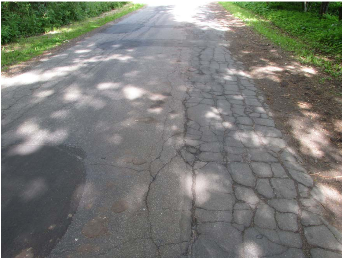
Bild 4: Schadensbild im Bereich Stat. 0+490 bis 0+635
