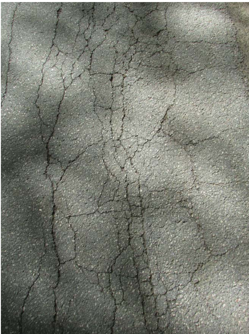
Bild 3: Netzzrisse im Bereich Aspelweg
